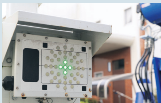
架線物仮移設時の電線荷重によるジャッキ反力減少割合をLEDで表示
