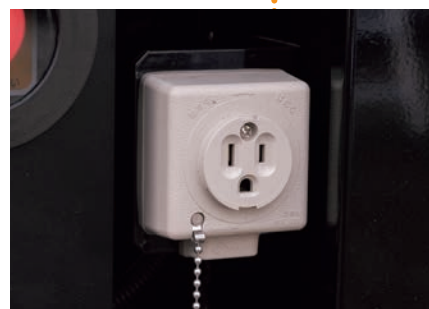
≫下部100Vインバーター電源取出口 下部操作装置の横に100V電源取出口を設置
