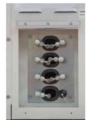
≫ 異常時油圧投入口 (鉄輪、転車台操作) 03
