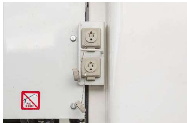
≫ 上部100V電源取出口 01
