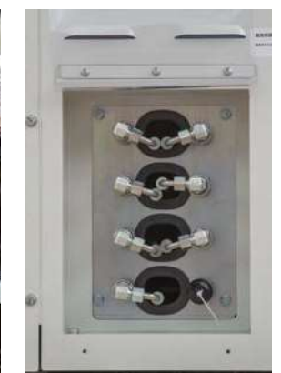
≫ 異常時油圧投入口 (鉄輪、転車台操作) 03
