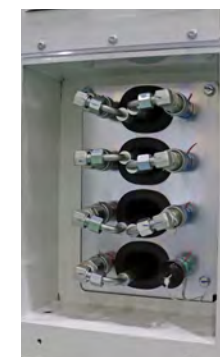
≫ 異常時油圧投入口 (鉄輪、転車台操作用)
