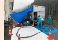
電源車で避難所への電力供給
